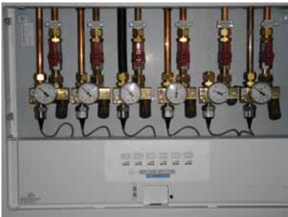
Leidingen achter de muur.
